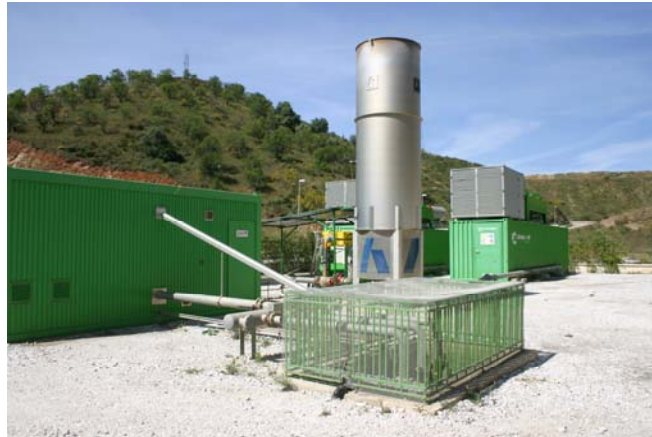
Planta de desgasificación y aprovechamiento eléctrico
